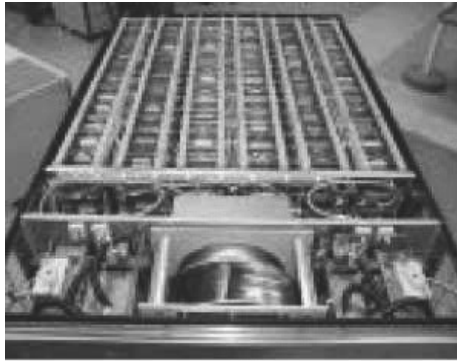
Fot.1.2.2. Wygląd bufora energii elektrycznej do odzyskiwania energii hamowania tramwaju [5]
